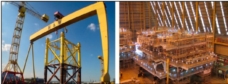
Şekil 9.7. DRES şalt sahası alt taban ve tepe kısmı.
