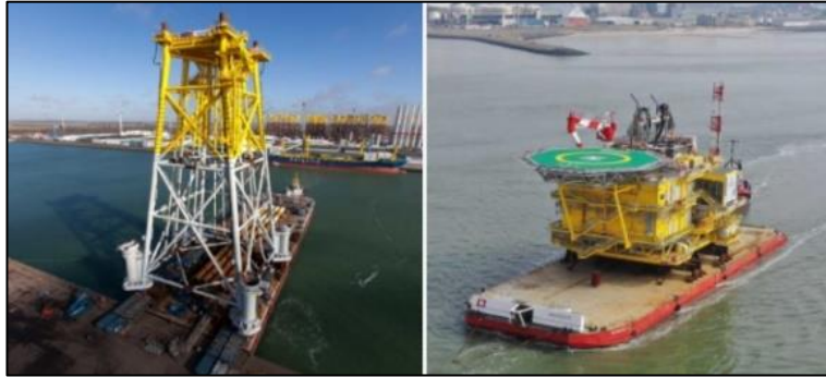
Şekil 6.19. DRES şalt sahası alt ve üst yapı.
